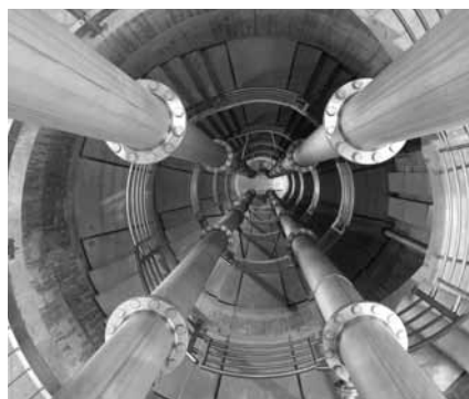
Steigrohre im Grundwasserpumpwerk Schaffhausen (Abb. aus dem Neujahrsblatt der Naturforschenden Gesellschaft Schaffhausen „Schaffhauser Wasser“, Nr. 60 / 2008)
