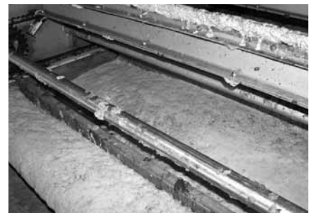
Ein Fettabscheider in der Abwasservorbehandlung der Nahrungsmittelindustrie trägt zu einer deutlichen Reduzierung der organischen Belastung bei.
